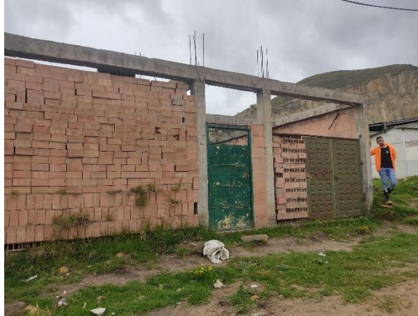
Salón comunal sin plancha
